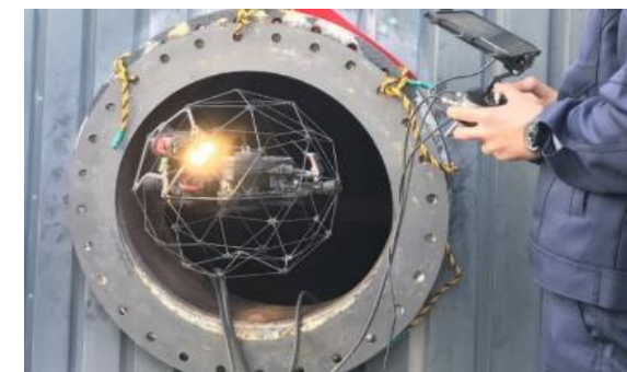
【デジタル技術を活用した効果的な予防保全の例 (ドローンを用いたタンク内部の点検)】
