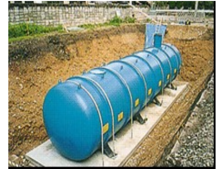
【耐震性貯水槽】
